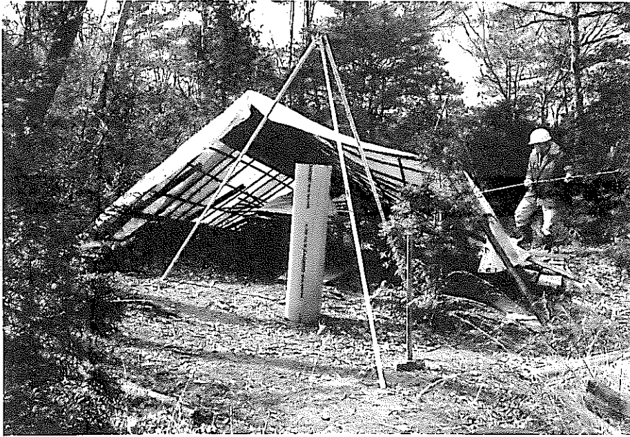
TH-7孔 計測小屋圧壊状況
