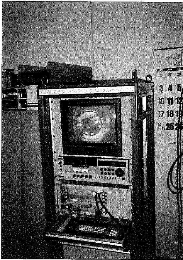
写真－２１ ＢＴＶ制御部
