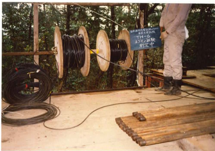
送水ホース、エアホース
