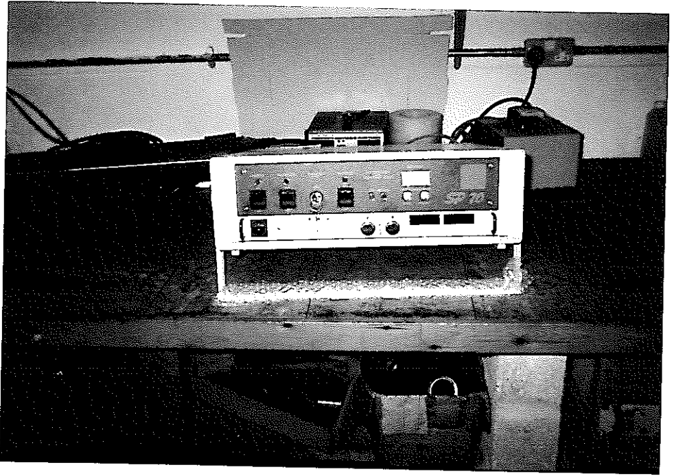
写真 4-1 地上コントロールユニット
