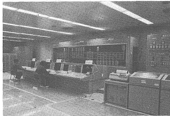
ペレット製造工程制御室
