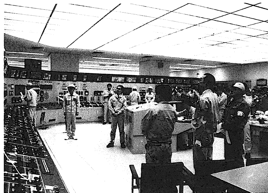
1次主循環ポンプ起動試験
