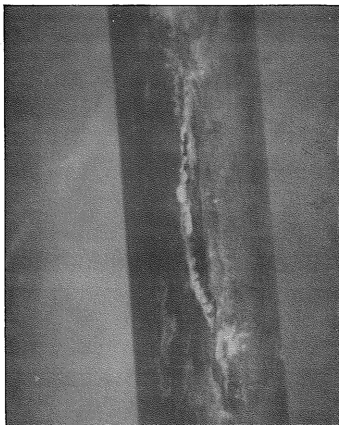
写真 3-5 NO. 6 部破損状況
